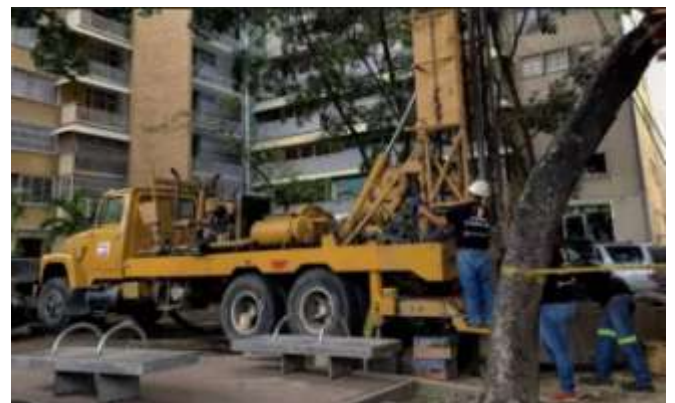
Perforación de pozos de agua en Caracas: una solución privada ante la decadente prestación de un servicio público vital
